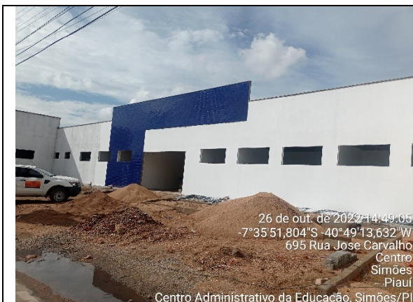
Foto 5 – Área externa sem a execução de piso cimentado, pátio/estacionamento e passeio em piso intertravado, apesar desses serviços terem sido medidos e pagos por completo.
