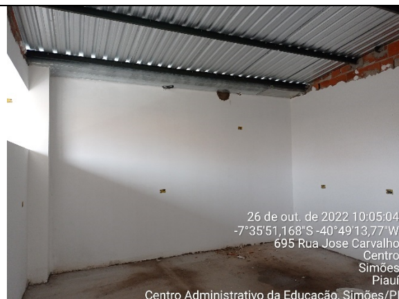
Foto 6 – Instalação elétrica, com execução de caixas 4x2 e eletrodutos, mesmo a obra tendo sido licitada sem o projeto elétrico (plantas e planilha). Ausência de piso cerâmico.
