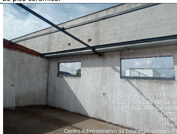
Foto 8 – Parte da obra, sem cobertura, sem piso cerâmico, sem pintura (apenas com fundo selador), apesar desses serviços terem sido medidos e pagos na sua totalidade.
