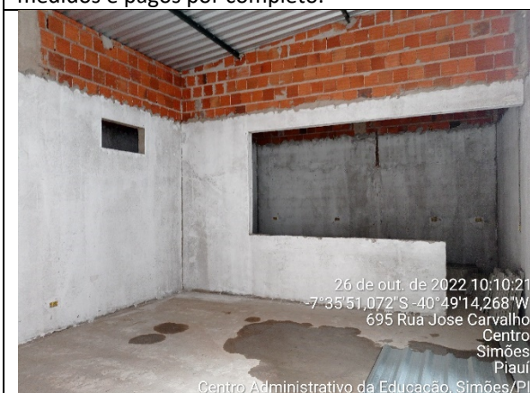
Foto 7 – Na cozinha, paredes somente com o fundo selador, ausência de piso cerâmico, ausência de revestimento cerâmico, ausência de bancada em aço inox. Serviços que foram medidos e pagos.
