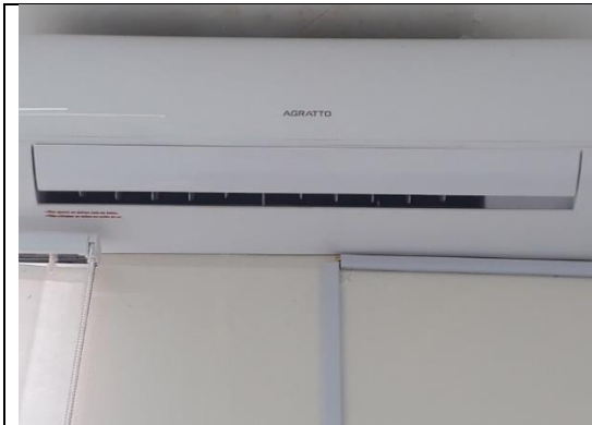
Foto 01 – Modelo de ar-condicionado adquirido em desacordo com o proposto pela contratada.
